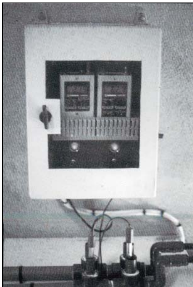
pHmetro y conductímetro instalados con carácter informativo en un sistema de balsa.
