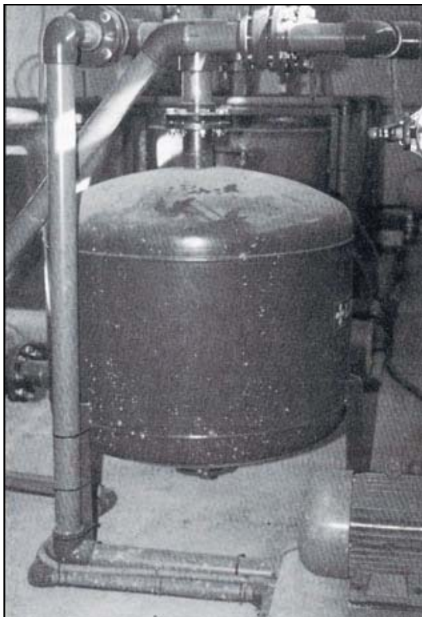
Filtro de arena.
