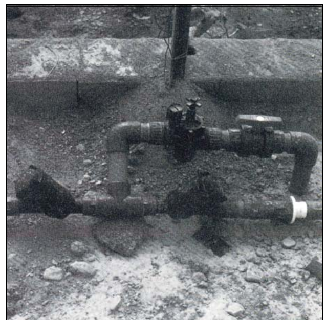
En cada subsector se debe colocar un regulador de presión que controle dicha presión independiente de las oscilaciones en las tuberías principales.
