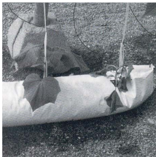
Obstrucción de goteros por una mala instalación de filtrado.
