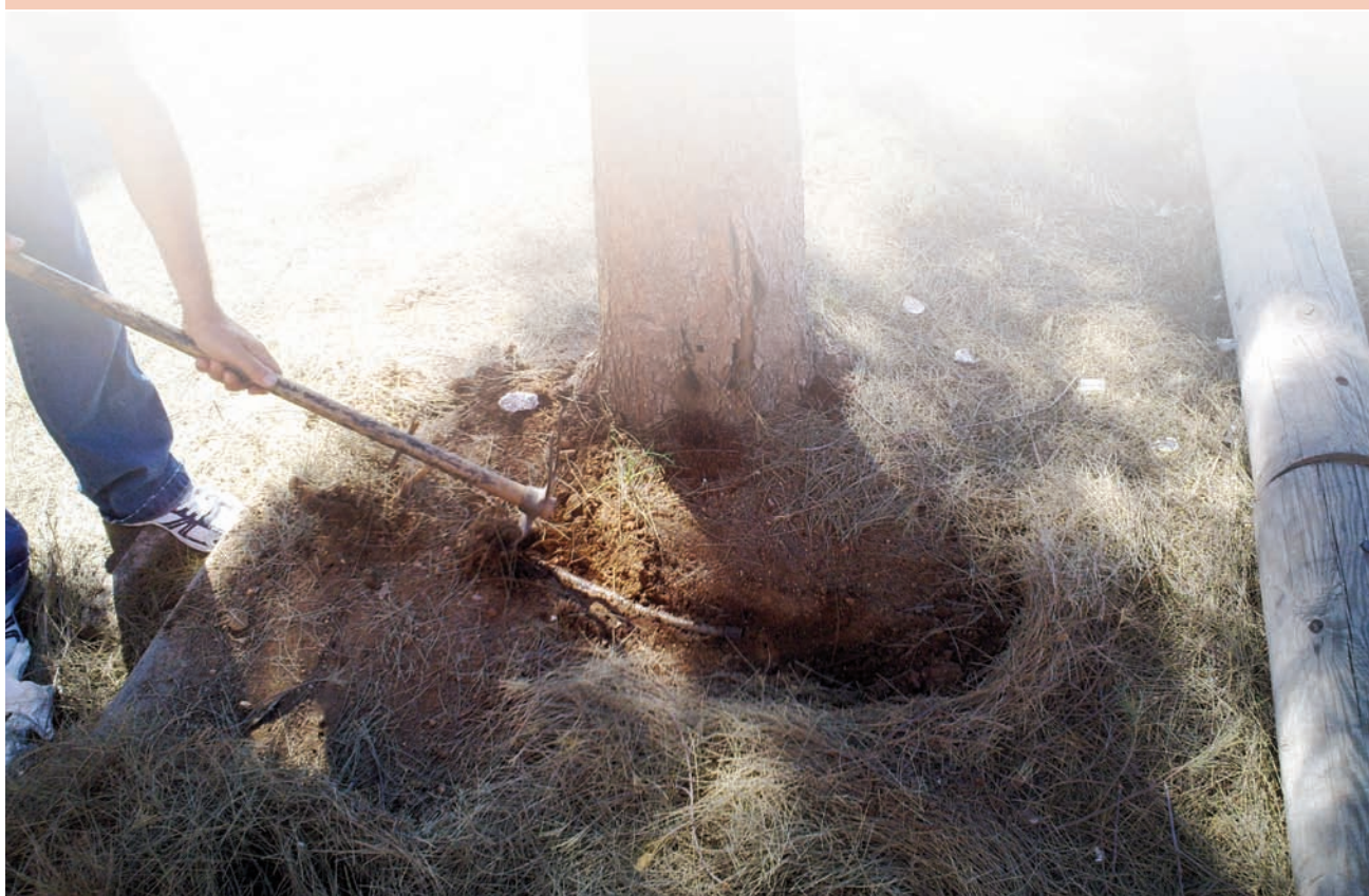
TTE de la marca Porec, enterrado a 10 cm de profundidad.
