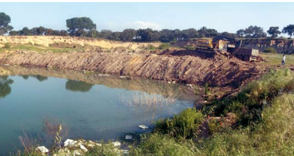
Foto superior: Aspecto general del área a rehabilitar antes de la intervención.
